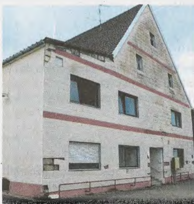
Die Gemeinde Haunsheim will das ehemalige Gasthaus Adler erhalten und den Abriss verhindern. Foto: Schopf (Archiv)
